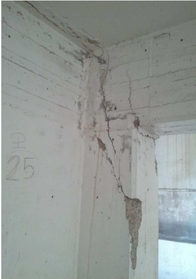
Figura 12 Lesione zona di appoggio portale piano cantinato
