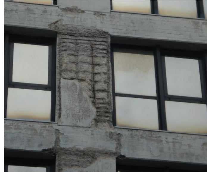
Figura 9 Pilastro interessato da estesa espulsione del copriferro
