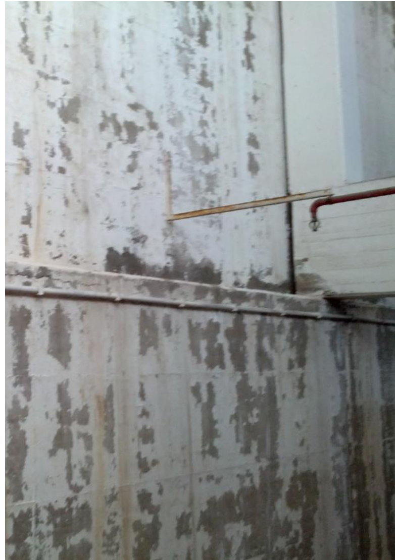
Figura 13 Infiltrazione nel piano cantinato in corrispondenza del muro perimetrale
