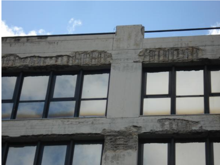
Figura 8 Travi interessate da estesa espulsione del copriferro
