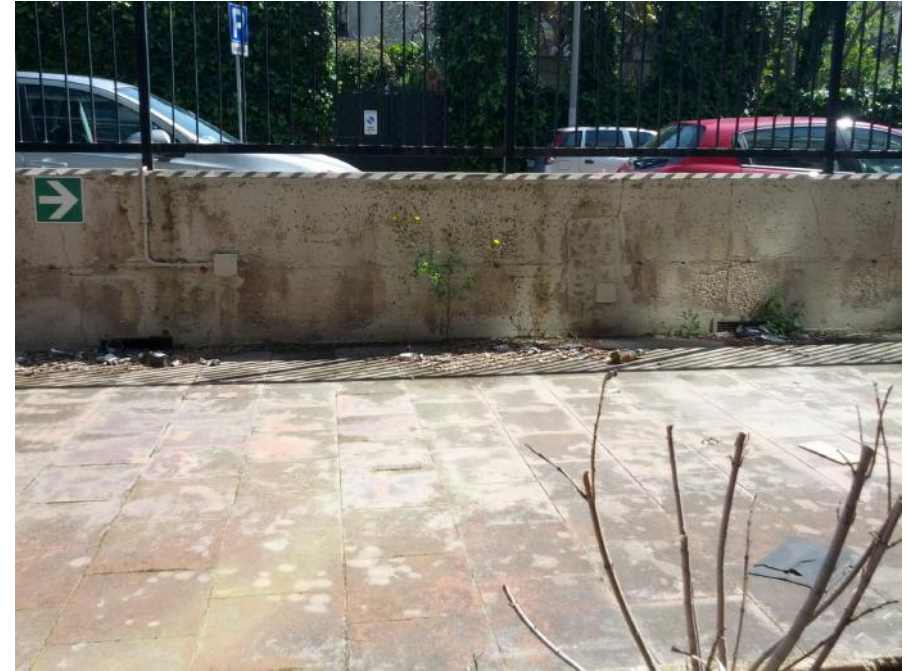
Figura 17 Pavimentazione a quota strada e bocchettoni per il deflusso delle acque completamente ostruiti
