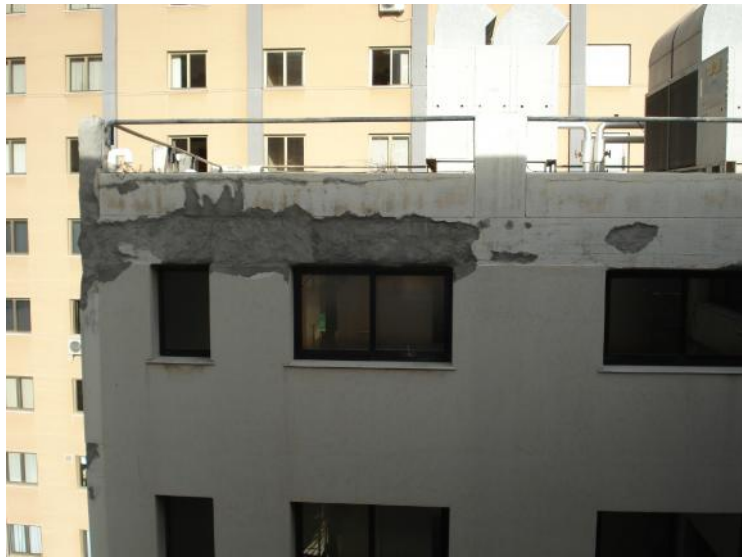
Figura 10 Zone interessate da degrado sottoposte ad interventi manutentivi precedenti
