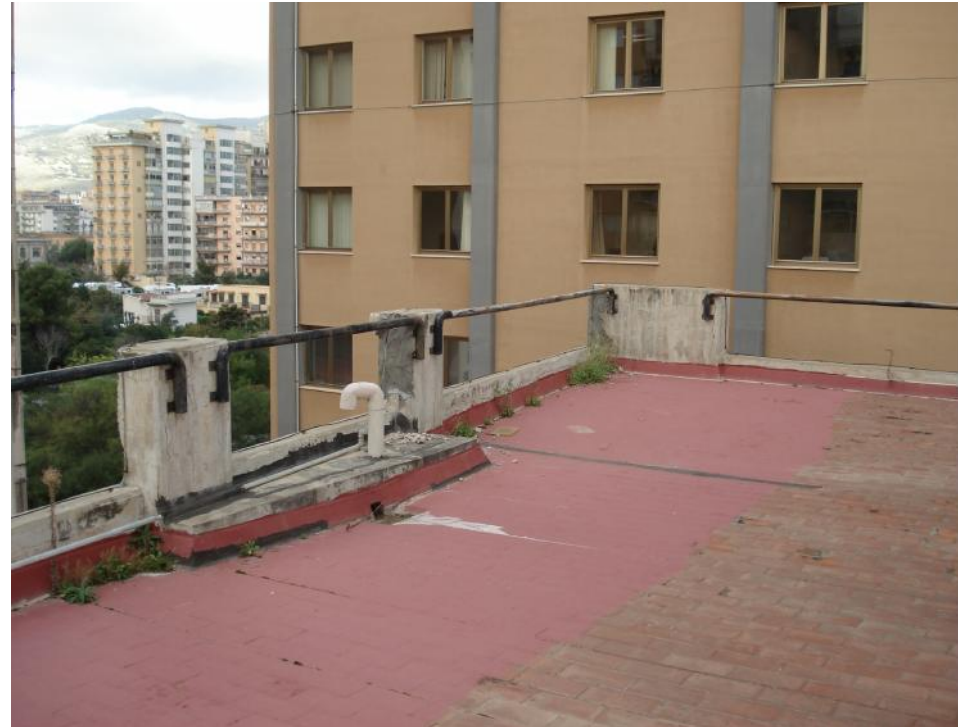
Figura 21 Vegetazione lungo il perimetro della copertura e evidenze d'interventi precedenti sulla pavimentazione
