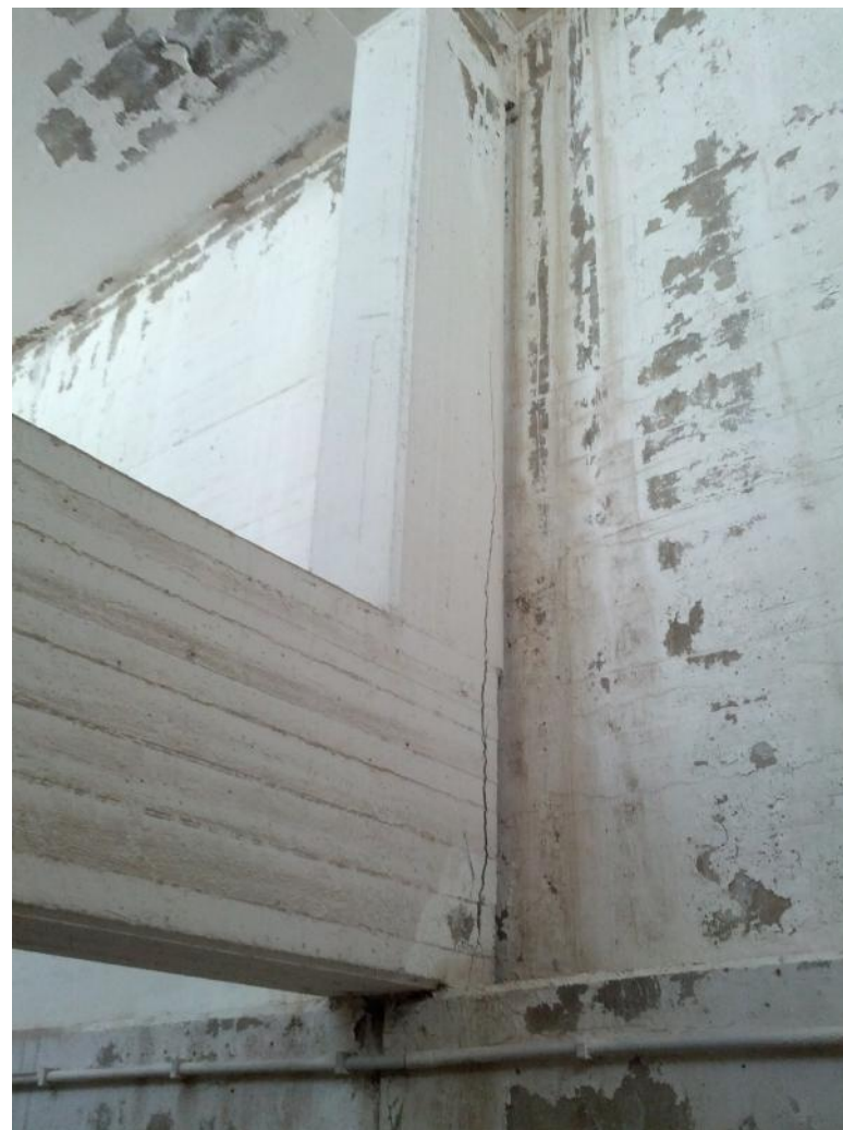
Figura 15 Lesione portale in corrispondenza dell'appoggio al muro perimetrale
