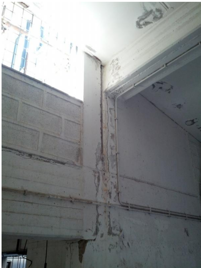
Figura 14 Lesione piano cantinato in corrispondenza del ballatoio
