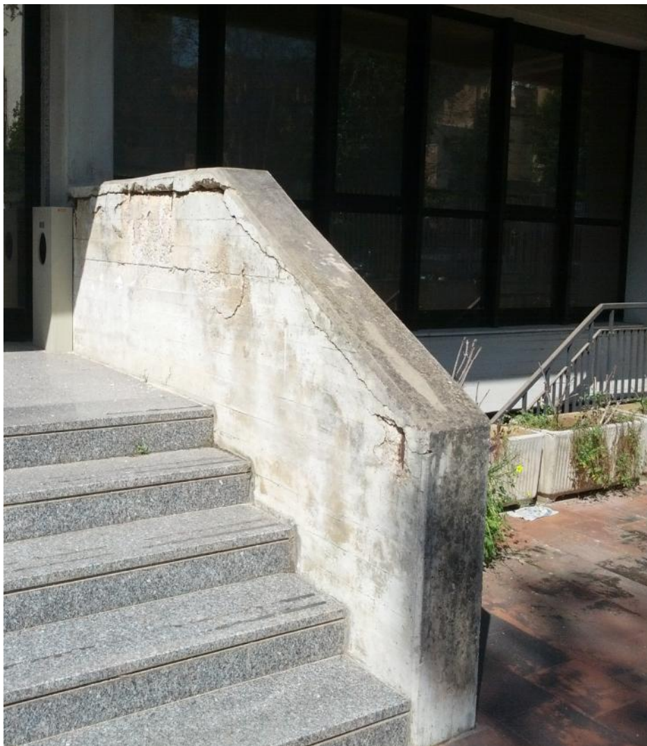
Figura 18 Lesioni sui parapetto delle scale di accesso all'immobile
