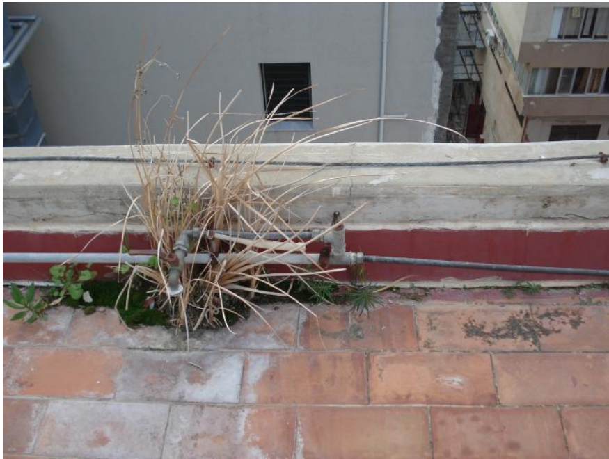
Figura 20 Vegetazione presente in corrispondenza dei bocchettoni di deflusso delle acque in copertura
