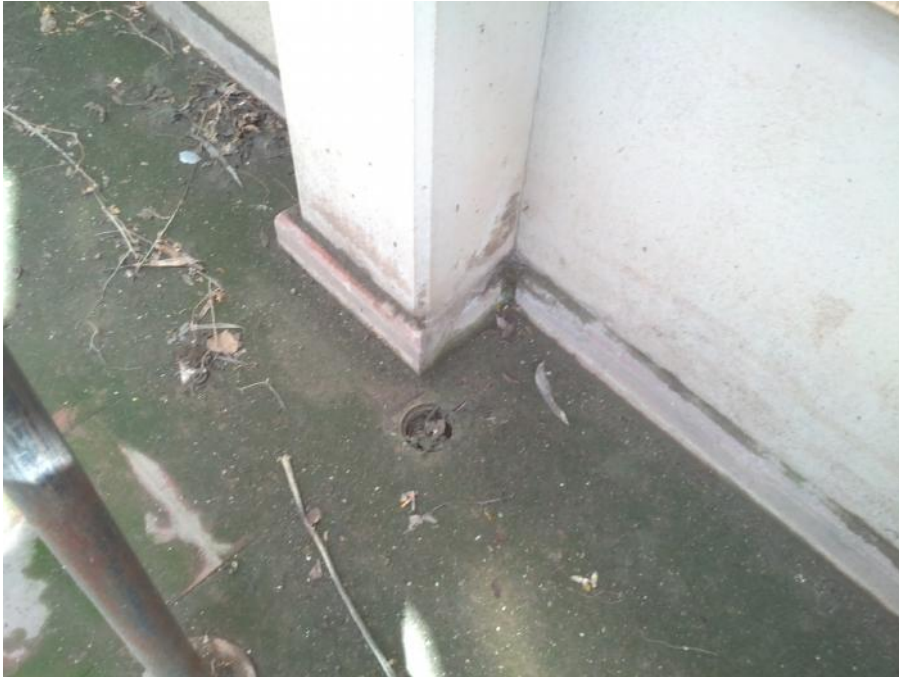
Figura 16 Presenza di vegetazione nella pavimentazione del ballatoio del piano cantinato
