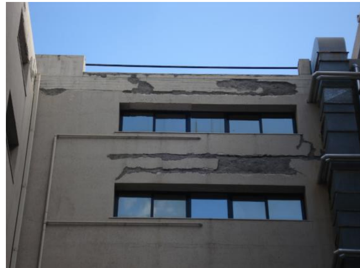
Figura 11 Zone interessate da degrado sottoposte ad interventi manutentivi precedenti
