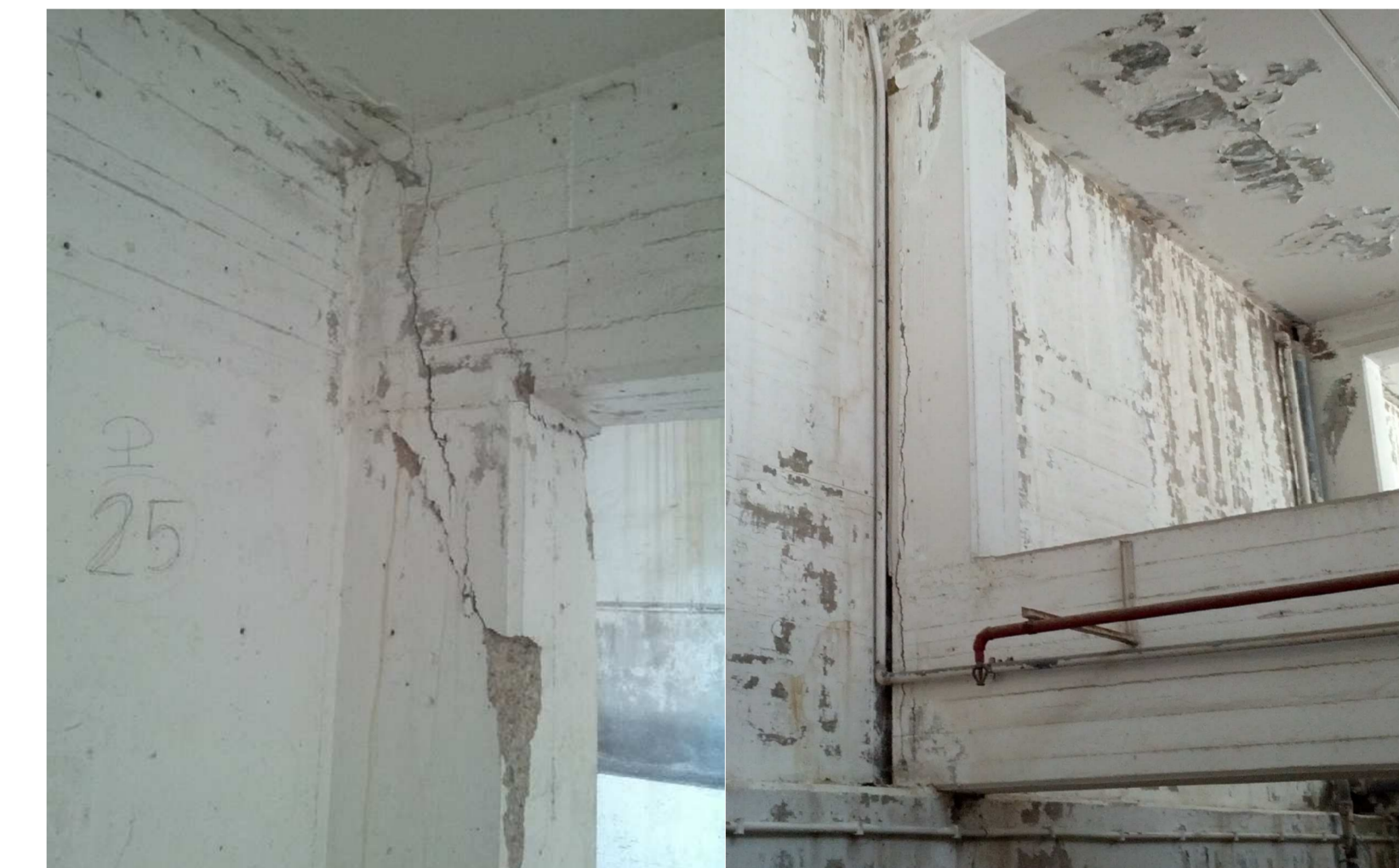
Foto 1- Lesioni pilastro nel piano cantinato
