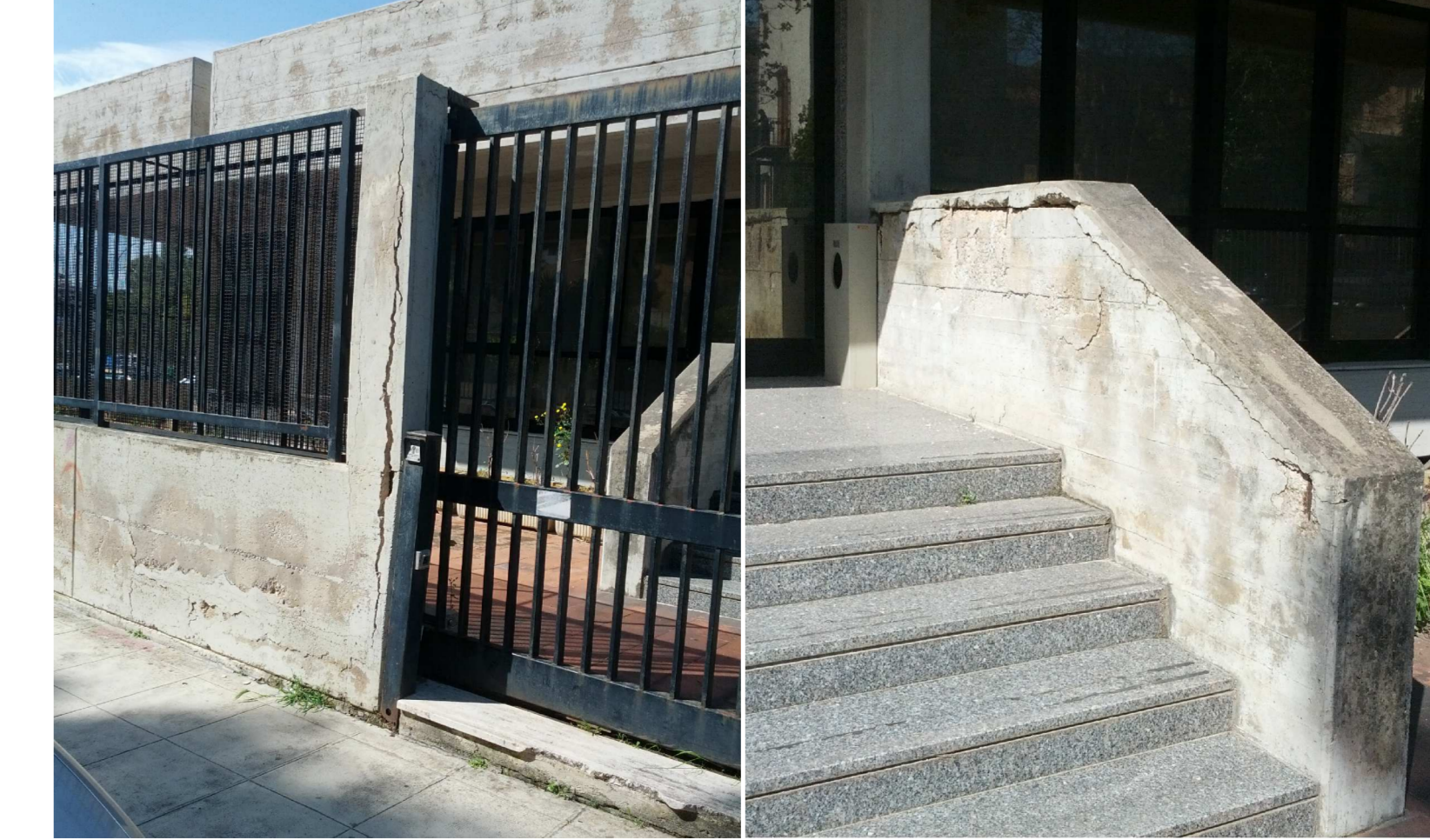
Foto - Lesione muretto di recinzione
