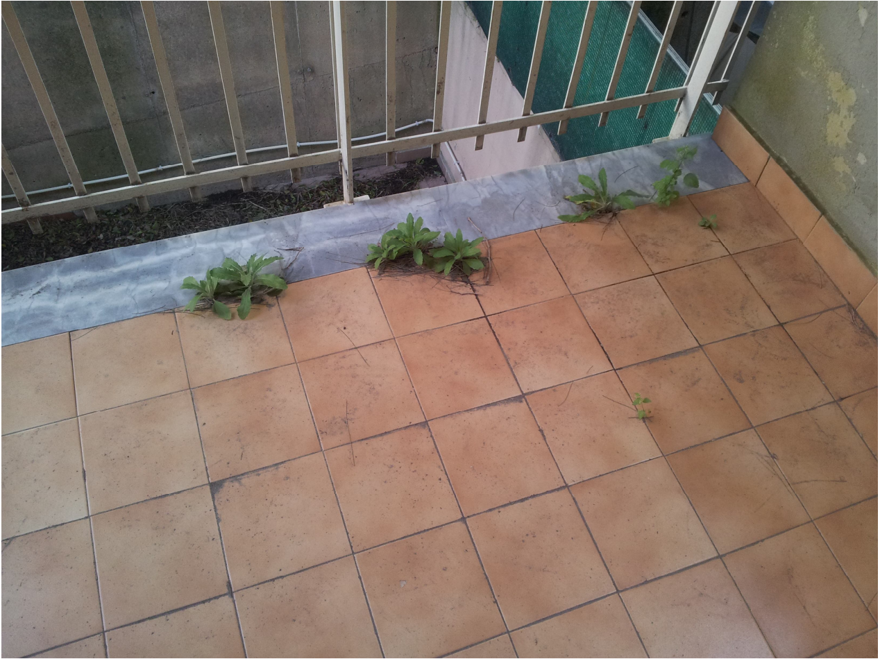
FOTO N°5 – PARTICOLARE PIANO CALPESTIO BALCONI
